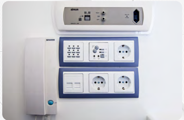
- Instalación eléctrica adaptada - Adapted electrical installation
